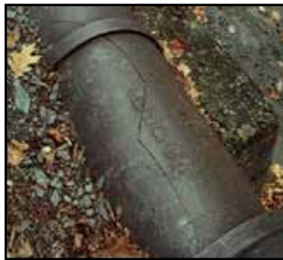
आकृति 5.5: पानी के नलों का टूटना (स्रोत: http://simscience.org/cracksadvanced/cracks1.html )
